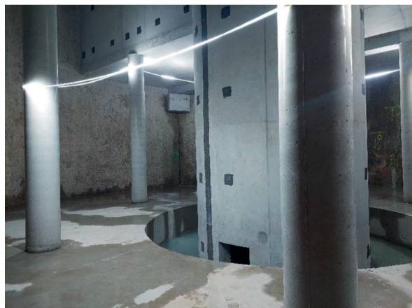
Dans les entrailles du bassin de rétention
